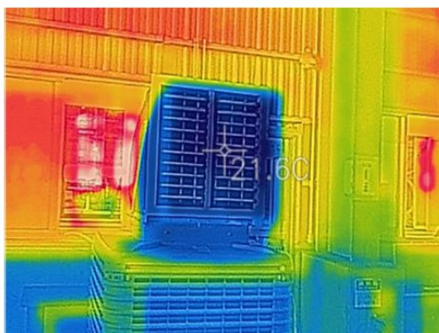
工場内温度約 26℃の時のネオクールの吹き出し口表面温度
